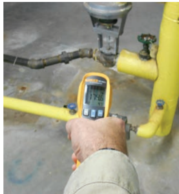
Überprüfung der Temperatur an der Kondenswasserleitung eines Kondensatabscheidungers auf ordnungsgemäße Funktion.
