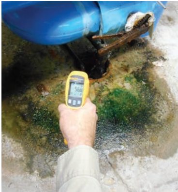
Temperatur von Kondensat messen, während es abfließt
