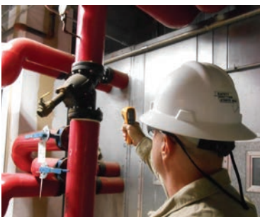
Wassertemperatur am Eingang zum Wärmetauscher der Luftaufbereitung prüfen
